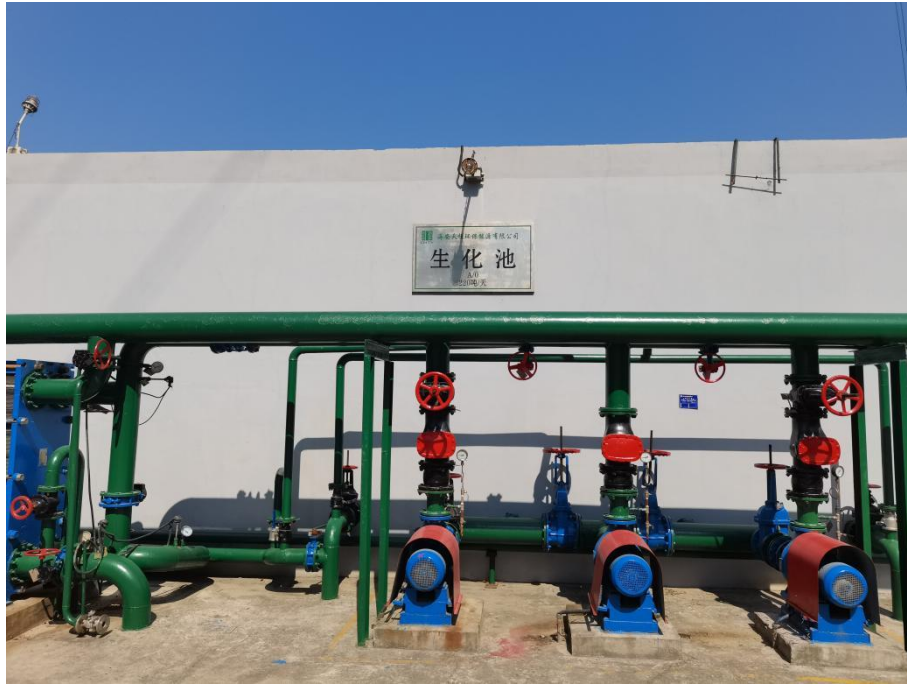
管道及污水处理厂区域
