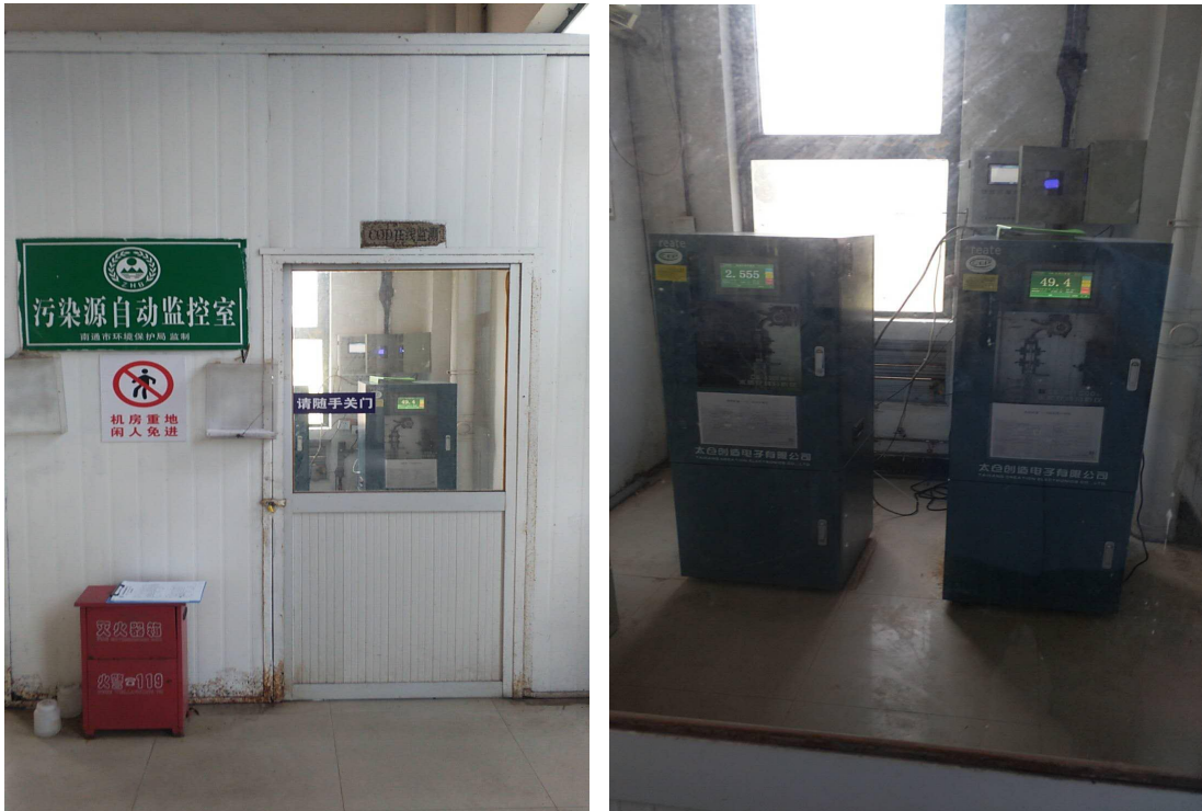
图 4.7 废水在线监测装置
